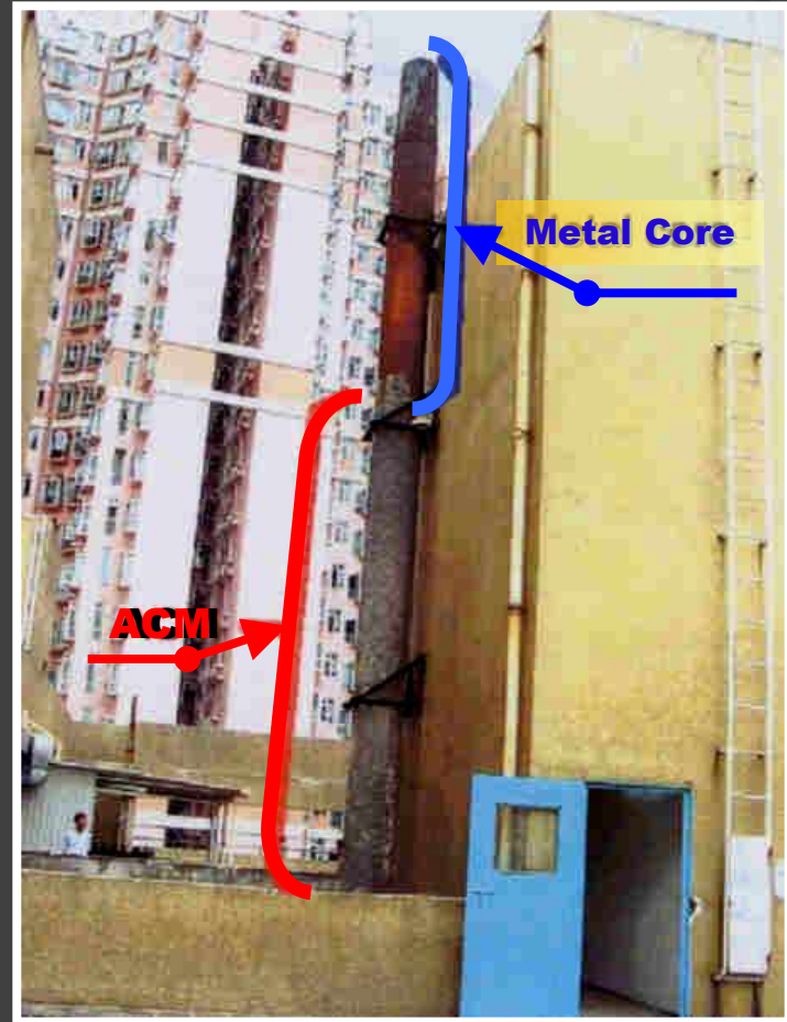
Chimney Lagging 煙囪隔熱物料
