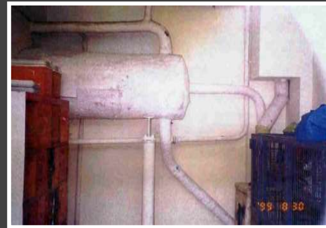
Boiler Lagging 鍋爐隔熱物料
