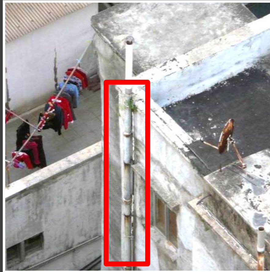
Sewage vent pipe 水泥污水管
